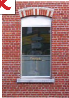
Disparition de l'imposte vitrée remplacée par un panneau plein
